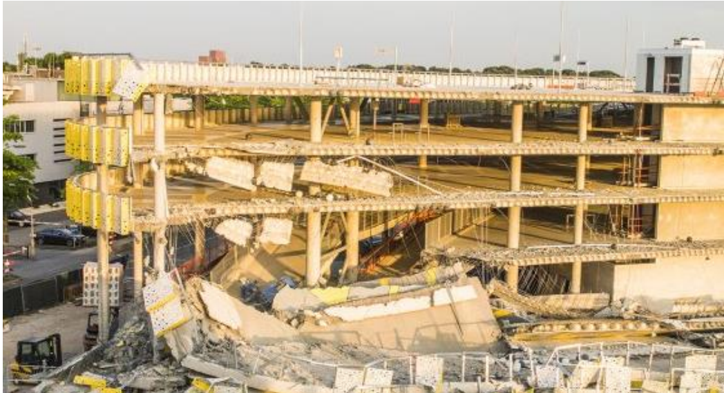
Ingestorte parkeergarage Eindhoven Airport - Sem van Rijsel
